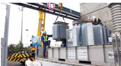
PCB廃棄物の処理
