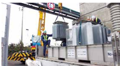
PCB廃棄物の処理
