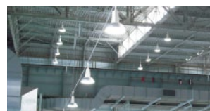
北九州工場の高天井LED照明
