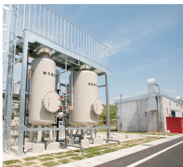
排水処理施設
