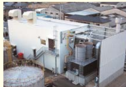
コージェネレーションシステム外観(尾西工場)
