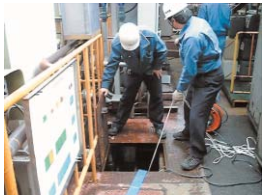
排水処理施設の緊急訓練（稲沢工場）
