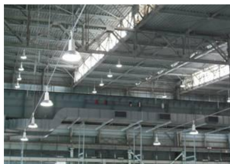
図 7．弊社北九州工場高天井照明設置状態
