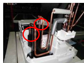
図-7 「ロウ付け」部位の一例
