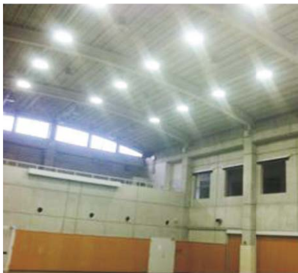
図-19 高天井 LED 照明の設置例
