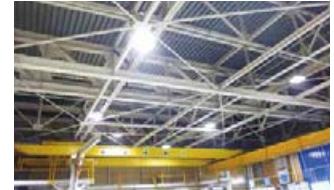
高天井LED照明
