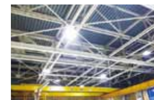
高天井LED照明
