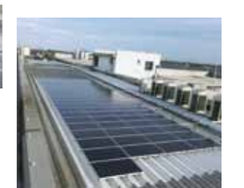
太陽光パネル/平和町工場
