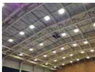
体育館公式競技用LED高天井照明
