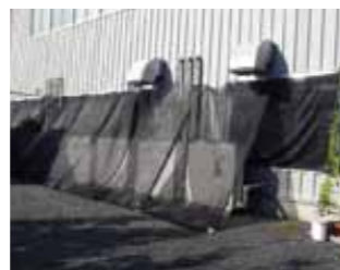
エアコン室外機の遮光対策
