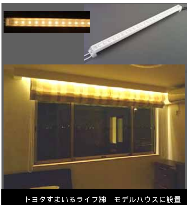
図11 LED間接照明をカーテンボックス内に設置
