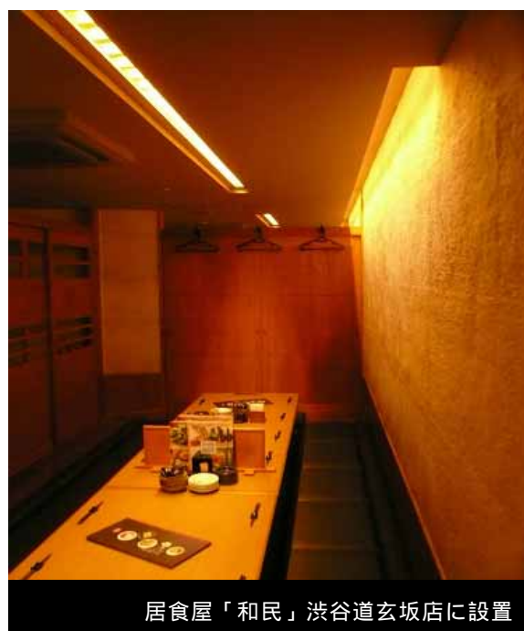
図13 キャンドル色のLED間接照明を壁際とテーブル上の天井内に設置
